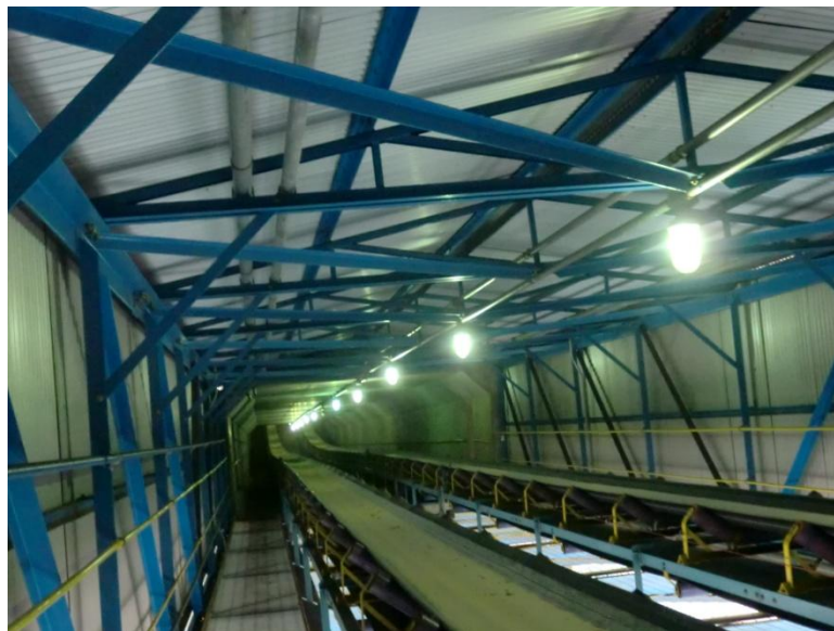
Figura 7. Esteiras que conduzem o açúcar até o armazém.
