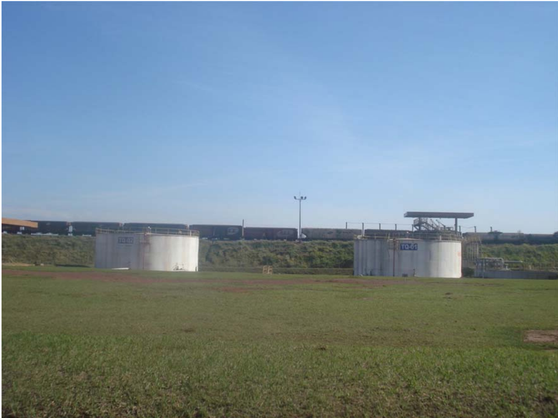
Figura 7: Tanques de Armazenagem de Etanol
